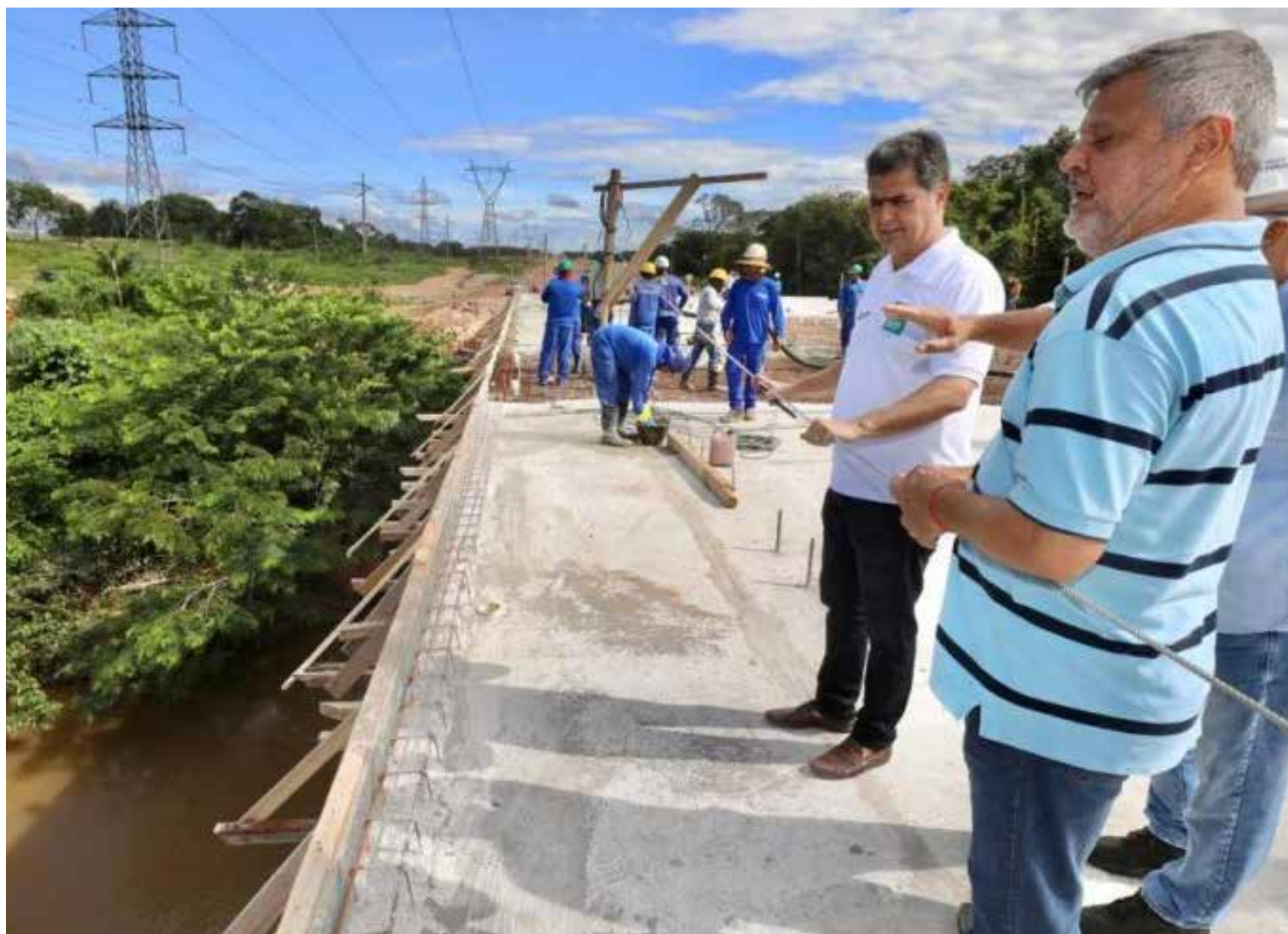
Prefeito Emanuel Pinheiro acompanha entrega da última etapa de concretagem da ponte sobre o Rio Coxipó, na Av. Contorno Leste
